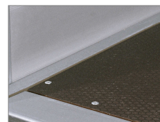
Flakytan skyddad av stålprofil
